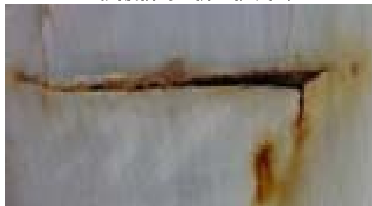
Figura 10. Fisuramiento del esquema B1 sobre acero galvanizado luego de 24 meses en La Voz.
