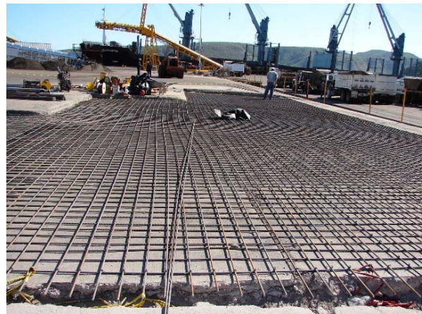
Figura 2. “Sobrelosa” en zona de hundimiento
