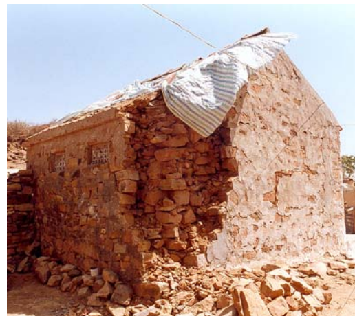
Fig. 9. Daños ocasionados por un sismo en estructura de mampostería sin atados.
