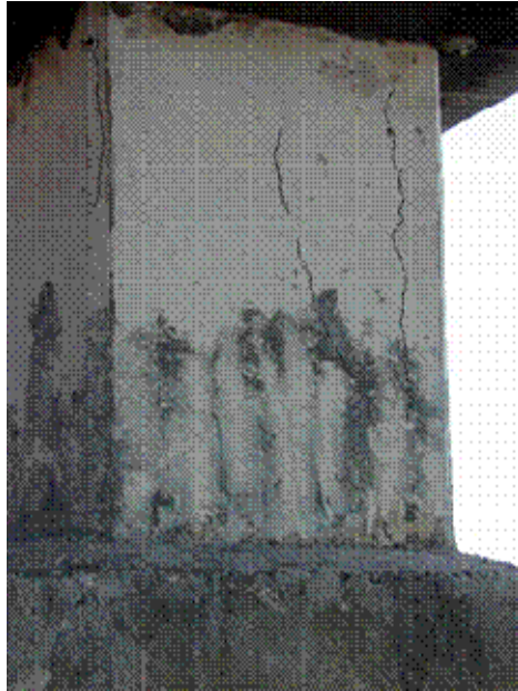
Figura 6. Agrietamiento típico presente en la superficie de los pilotes sobre el sistema de encapsulamiento con o sin protección catódica.
