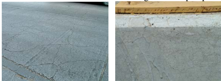
Figura 2. Deterioros debidos a ASR en la Vialidad Juan Escutia, y en el parapeto del puente Sacramento.
