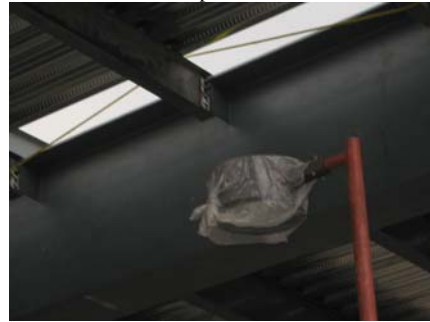
Langueros secundarios que quedaron cortos y no cuentan con atizadores en la viga a la que se conectan
