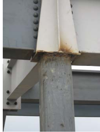
Soldadura en poste mal realizada
