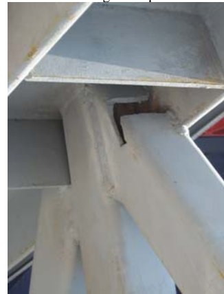
Perfiles con defectos de fabricación
