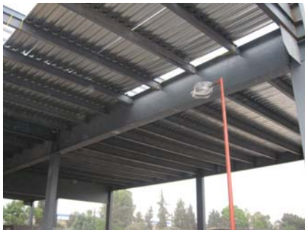
Langueros secundarios que quedaron cortos y no cuentan con atizadores en la viga a la que se conectan
