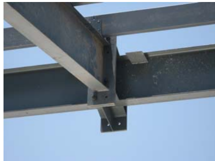
Fabricación de end plates incorrecta, no coinciden agujeros
