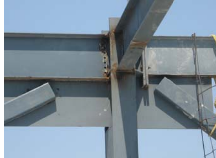
Conexiones realizadas sin respetar distancias mínimas a borde y agrandando agujeros con oxicorte para hacer coincidir banderas con perfiles
