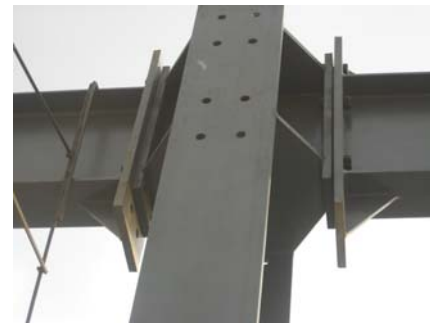
End Plates que no coinciden
