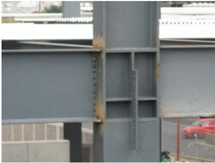
En banderas de cortante los agujeros para tornillos no coinciden por lo cual es imposible colocar tornillos
