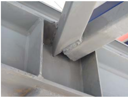
Armaduras cortas no llegan a conectarse correctamente a trabe lateral
