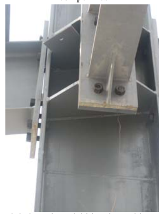
Pendiente mal dada a vigas debida a lo cual las conexiones no coinciden
