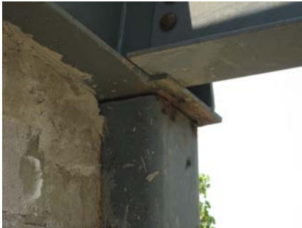
Poste que sostiene volado el cual no se soldó solamente se punteo con soldadura
