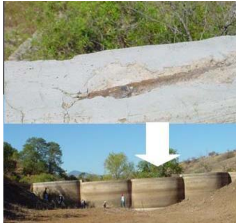
Figura 6.- Desprendimiento del mortero de recubrimiento en la parte superior del arco.
