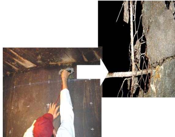
Figura 4.- Se observan manchas de herrumbre en todo el refuerzo de la muestra del cascarón. (Malla electrosoldada, tela de gallinero y metal desplegable)
