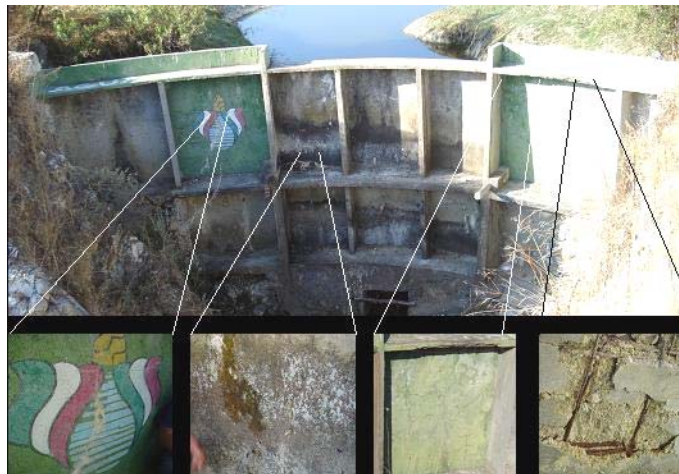
Figura 5.- Evidencia de deterioro por corrosión. a).- grietas, b).- manchas de herrumbre c).- desprendimiento de recubrimiento y d).- delaminación y acero corroído.
