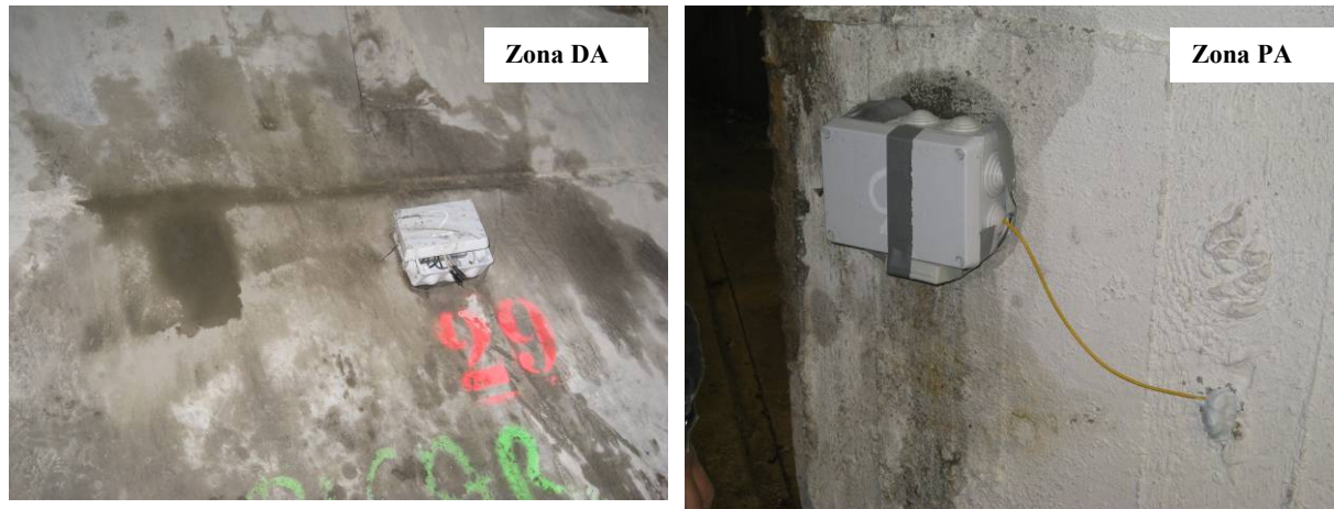
Figura 4. Puntos de instalación de los sensores.
