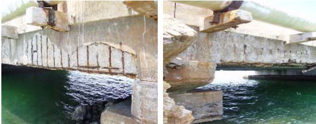
Figura 3. Desprendimiento del recubrimiento y pérdida de sección de la barra de acero.
