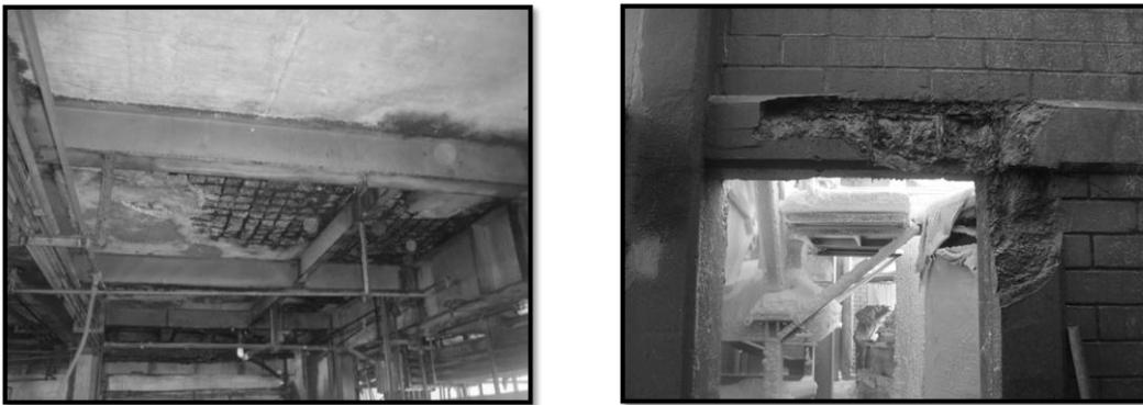
Figura 1. (a) Daño por corrosión en losa en el interior de la fábrica; (b) Daño por corrosión en trabe en zona anexa a la de exposición de especímenes
