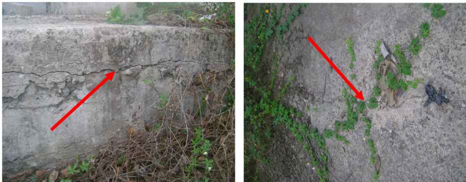
Figura 3. Daños producidos en el contrapiso por ataque de la vegetación local.
