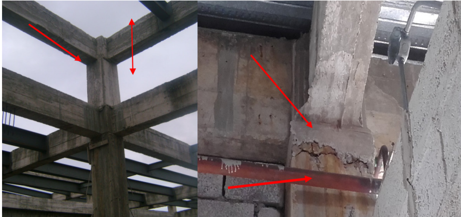
Figura 5. Columna corta y daño mecánico en cabeza de columna y manchas de color marrón producto del sangrado de la oxidación del acero de refuerzo por el abandono producido.
