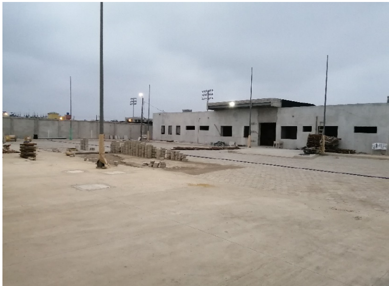
Figura 27. Proceso de terminación del Centro Medico Tipo C denominado El Paraíso, Estructura reforzada con muros de corte y encamisado de columnas.
