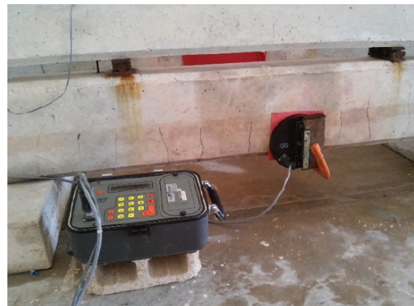
Figura 4. Lecturas con corrosímetro comercial.
