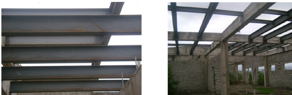
Figura 7. Vigas metálicas ASTM A36, no presenta manifestaciones Patologicas.
