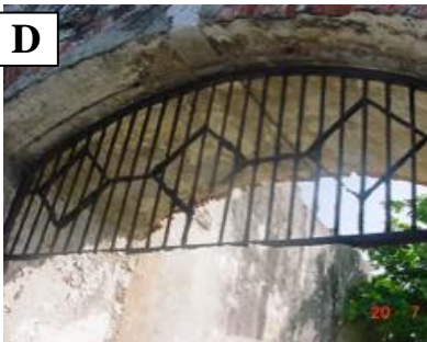
D: Reja metálica, M 9 expuesta a vientos marinos
