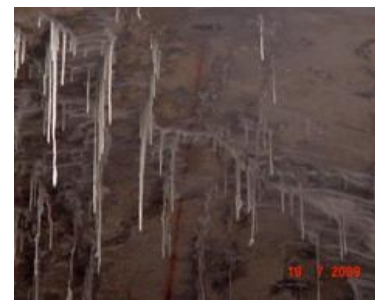
Evidente carbonatación. Zonas interiores. Cortina Sur
