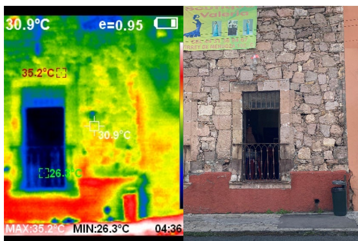
Figura 8. Foto térmica de una fachada de la calle Virrey de Mendoza, orientada hacia el oeste en el centro histórico de la ciudad de Morelia.
