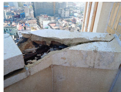
Figura 4. Fractura de las barandas de terra cotta de los balcones por corrosión.
