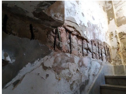
Figura 1. Corrosión, manchas de lixiviación y eflorescencia en vigas, losas y columnas.
