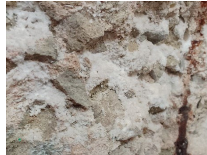
Figura 2. Precipitación de sales y lixiviación sobre la superficie del hormigón
