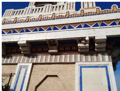
Figura 3. Fractura de viga y ménsulas por corrosión.
